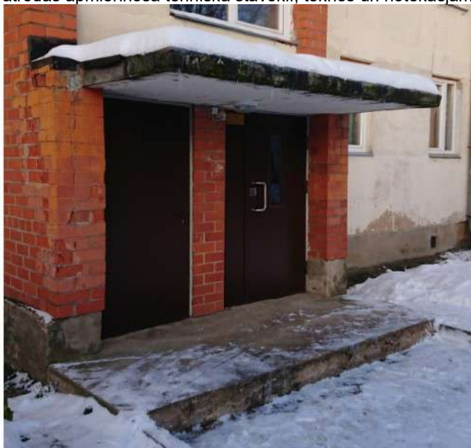
5.att. Jumtiņa mūra balsti daļēji remontēti; ieteicams izbūvēt jaunus ieejas mezglus.
