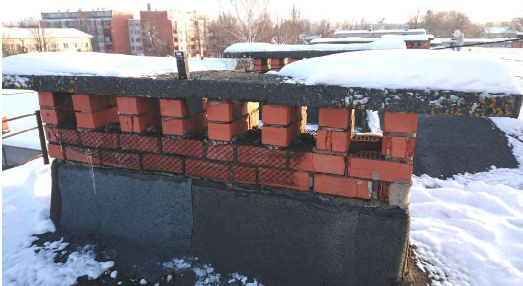
17.att. Redzams atjaunotais jumtas segums; mūra ventilācijas izvada mūris daļēji bojāts.
