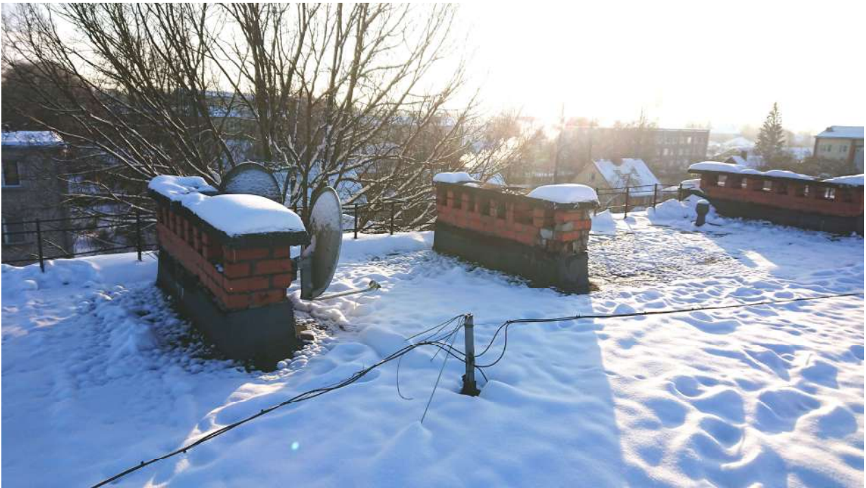
19.att. Jumta virsma fragmentāri nelīdzena, redzamas jumta margas, sakaru kabeli, satelītšķivji.
