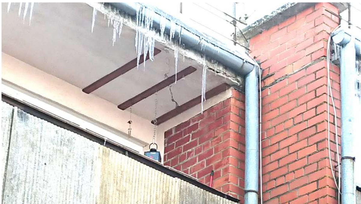
9.att. Vairākiem lodžiju pārsguma paneliem bojāta apakšējā betona aizsargkārtā;dažiem ir plaisas, kas jāremontē.
