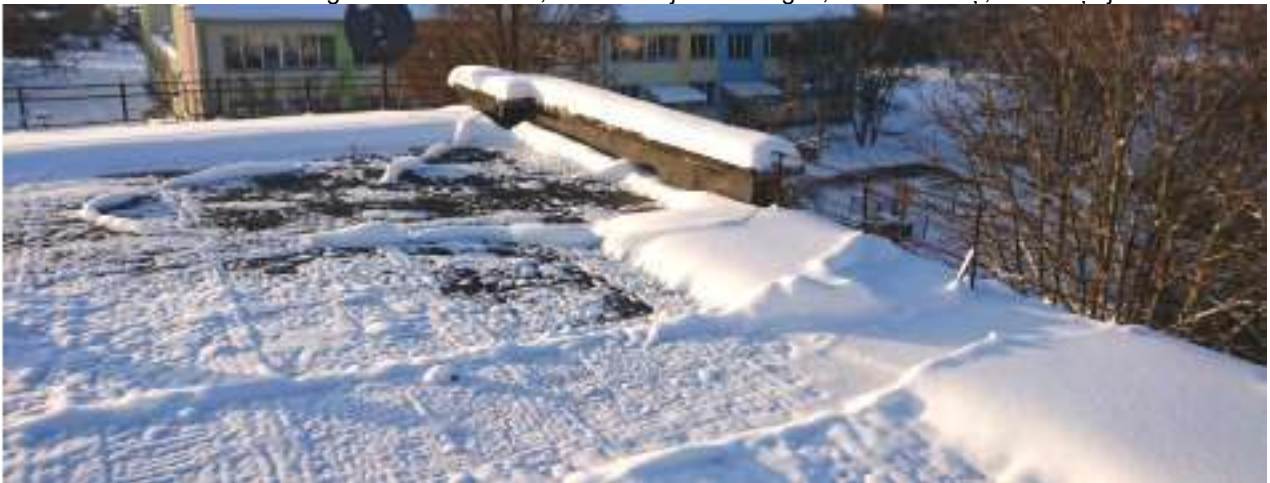
20.att. Ēkas stūros redzami parapeti; jumta margas; visi jumta elementi jāatjauno.
