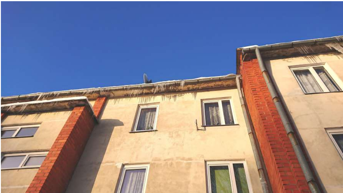
3.att. Mūra pilastrī atrodas apmierinošā tehniskā stāvoklī; lietussūdens notekas nolietojusās un jāmaina.
